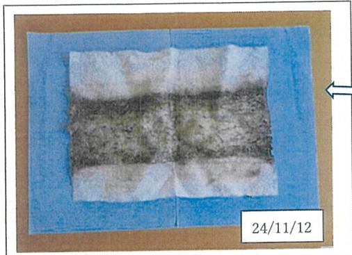
梅林通りに面した民家のテラス手すり清掃の ティッシュペーパー汚染跡（毎週 1 回清掃）
