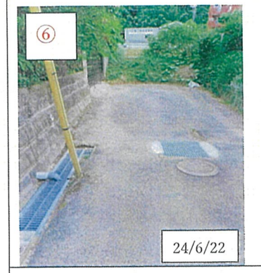
上諏訪通り民家 向こうの鮎川土堀 まで湛水し、駐車場の車が埋没した
