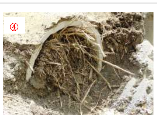
④ 水路変更用土管は土石枝木で塞がり、豪雨は 林道に溢れ、川となって下流に向かいました。
