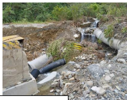
上流部左側、洪水跡
